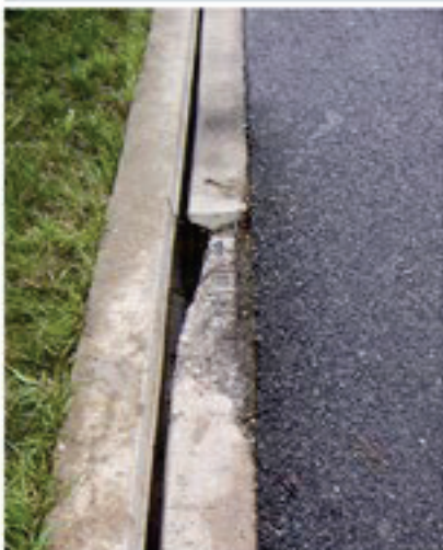
Schaden an Schlitzrinne Betonausbrüche an einer Schlitzrinne.
