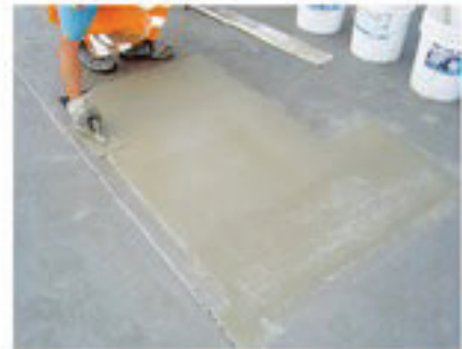
Glätten Das Glätten oder Abziehen muß unmittelbar erfolgen. Nach 8 Stunden ist bereits eine Druckfestigkeit von annähernd 30 N/mm 2 erreicht.
