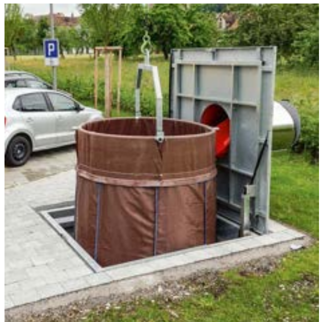
Sammelstelle mit Big-Bag SW 200 in Zuzwil (CH).
